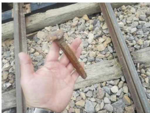
Figura 16 Defecto de no fijación en el durmiente
