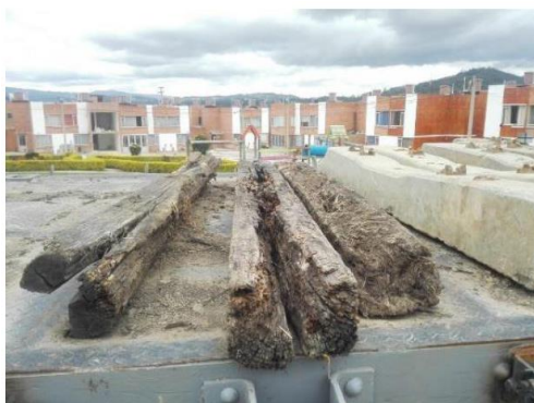
Figura 14 Pudrición del durmiente de madera
